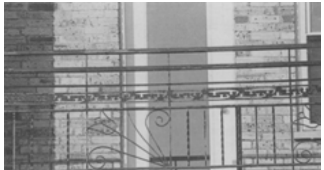
93. Exemple de travail de fer ornamental où l'on retrouve des retailles de lames de patins. Le garde-corps du bas a été surhaussé par l'ajout d'une seconde barre horizontale.
