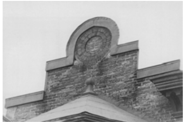
32. Disparition du couronnement par suite du remplacement de la corniche.
