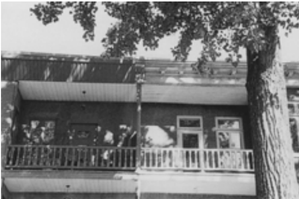
38. La disparition des détails de la corniche et le remplacement des éléments d'origine par des matériaux modernes, sur la partie gauche, portent atteinte à ce bâtiment en l'appauvrissant.
