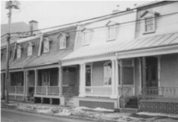
82. Lorsqu'une maison fait partie d'un ensemble, il est d'autant plus important de remplacer les garde-corps par un modèle identique ou similaire.
