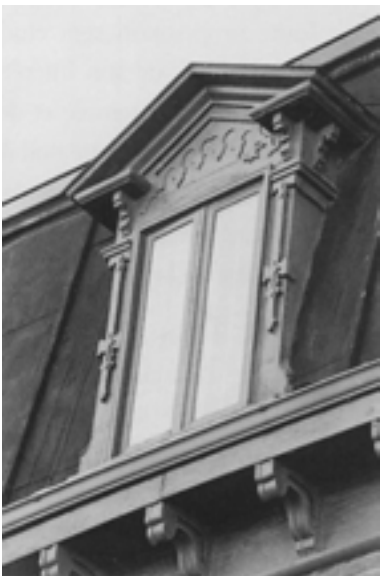
33. Corniche à simple soffite, gouttière soutenue par des consoles de bois et retenue par des attaches.
